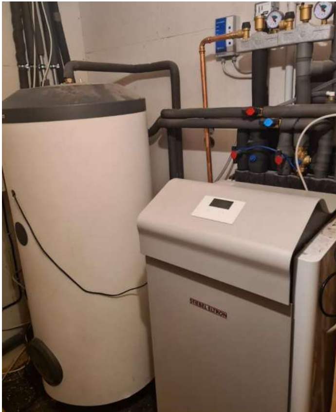
Wärmepumpe 10KW mit Pufferspeicher für Neubau Doppelhaus
